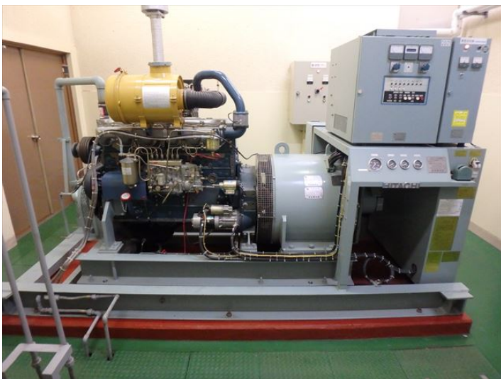
非常用発電機
