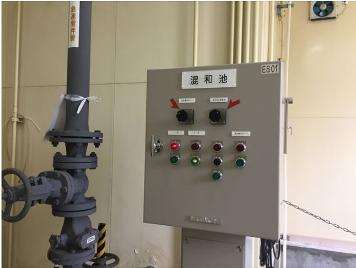
混和池操作盤
