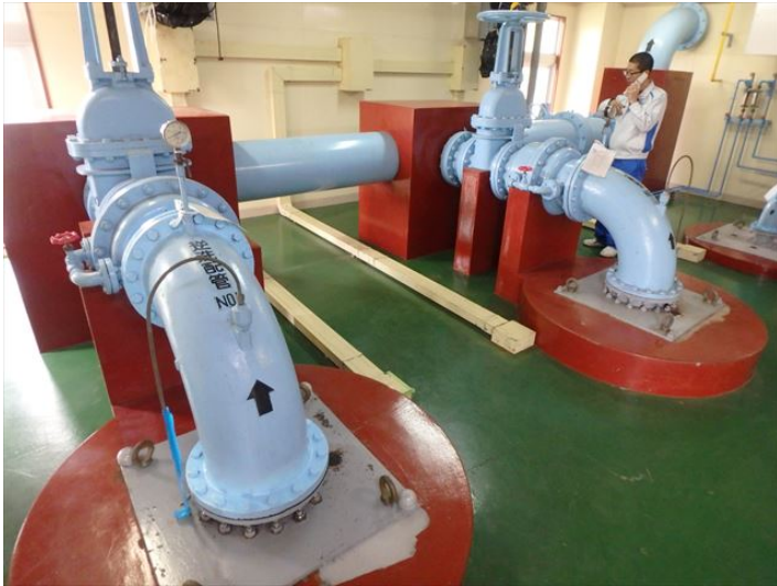
ろ過池逆洗配管
