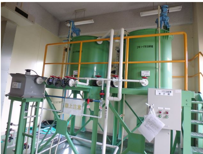
苛性ソーダ注入設備
