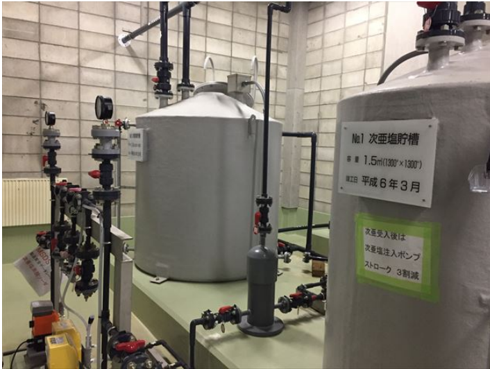
塩素注入設備
