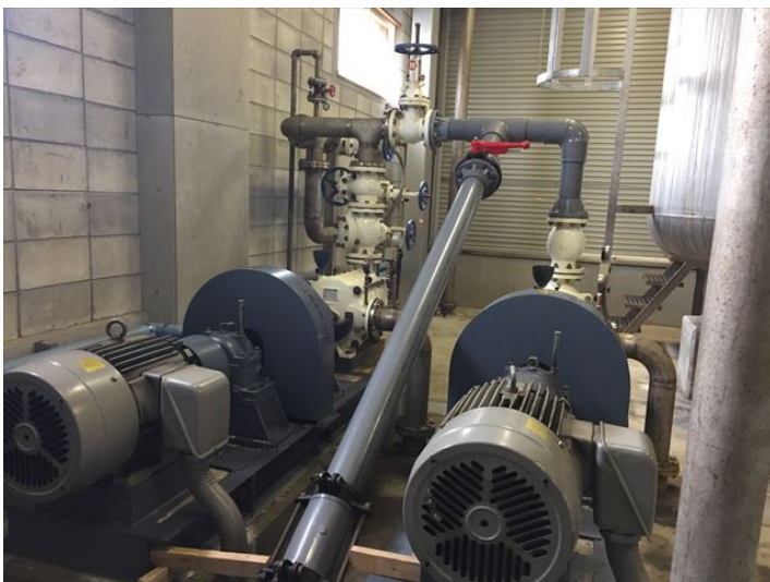
配水ポンプ、非常用連絡管
