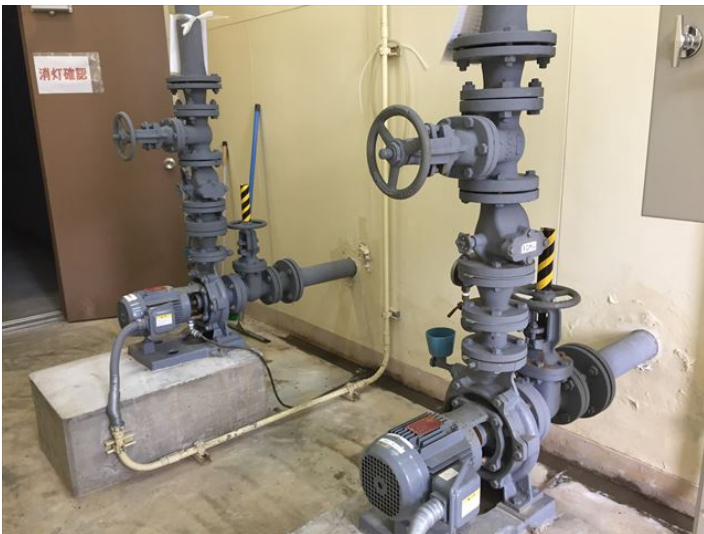
混和池機械設備
