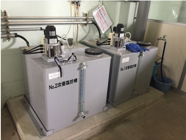
塩素注入設備
