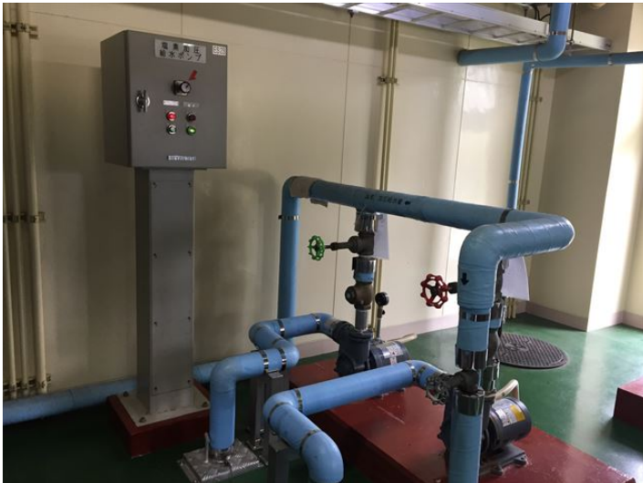
給水ポンプ操作盤
