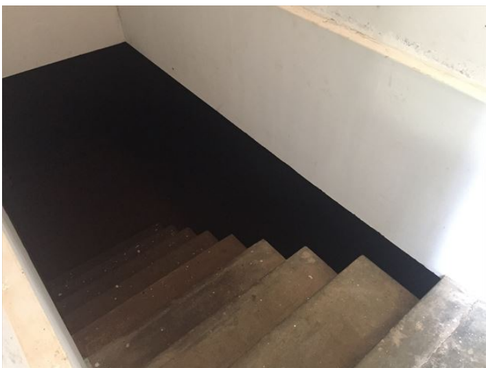
緩速ろ過池（降口）
