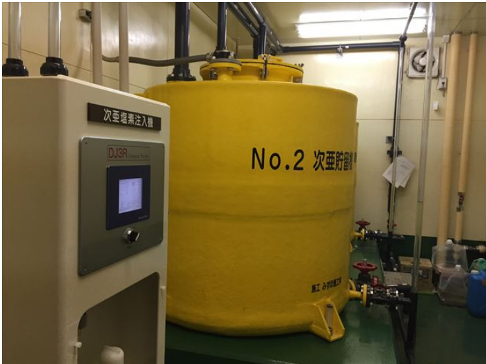
塩 素 注 入 設 備
