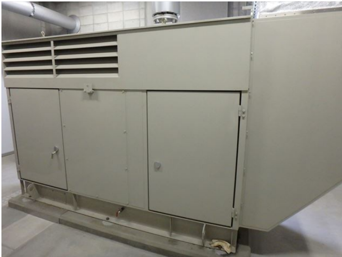
非常用発電機
