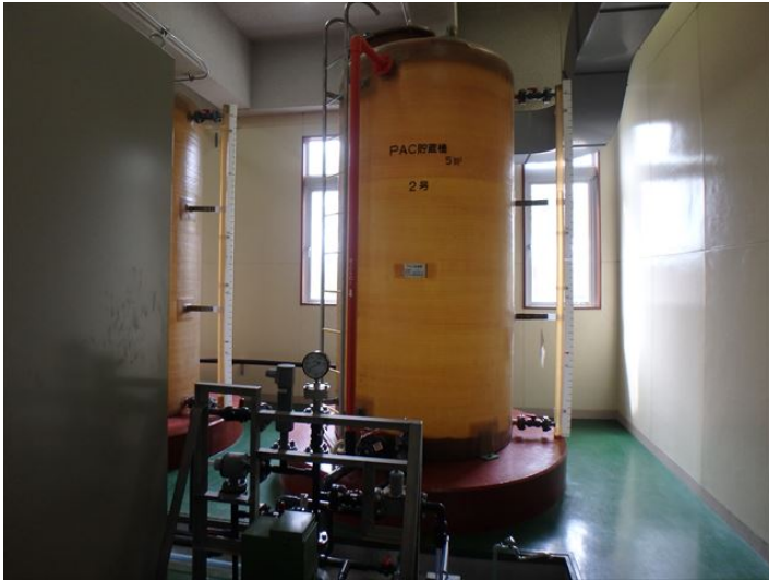
P A C 注 入 設 備
