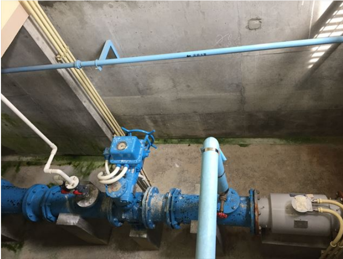
浄水場流入管
