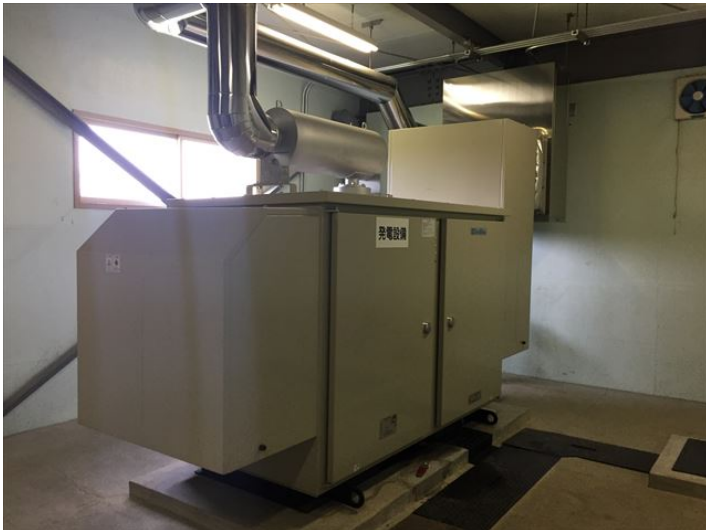
非常用発電機
