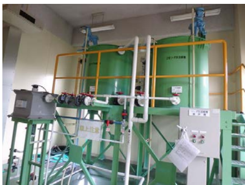
東山浄水場苛性ソーダ注入設備
