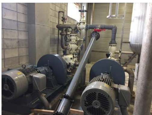
東浄水場配水ポンプ
