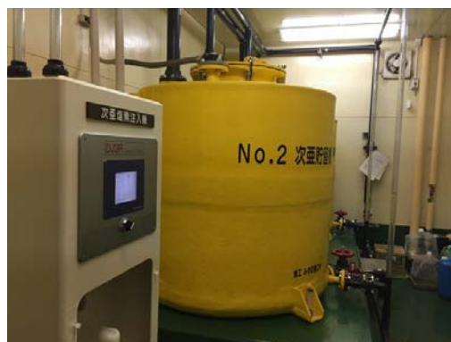
東山浄水場塩素注入設備
