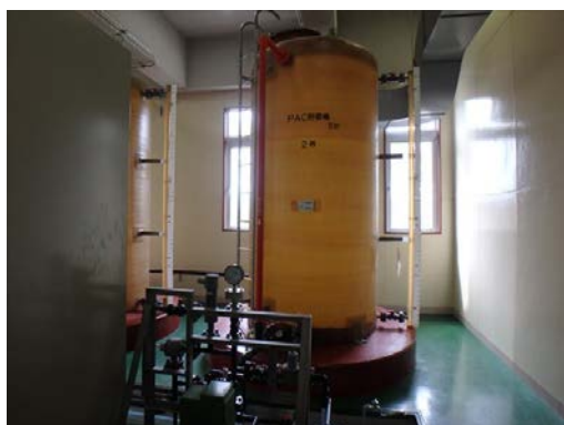
東山浄水場PAC注入設備
